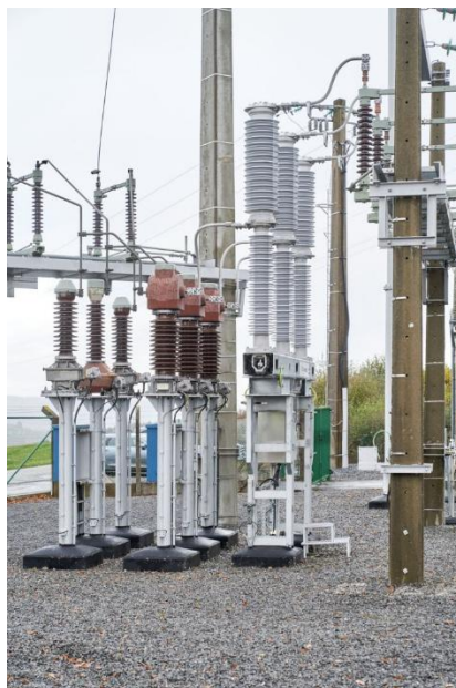
Figuur 2.6: Eerste SF 6 -vrije vermogensschakelaar van een nieuwe generatie op Elia-net op 70 kV (lichtgrijs toestel, in het onderstation van Marcourt 70 kV)
