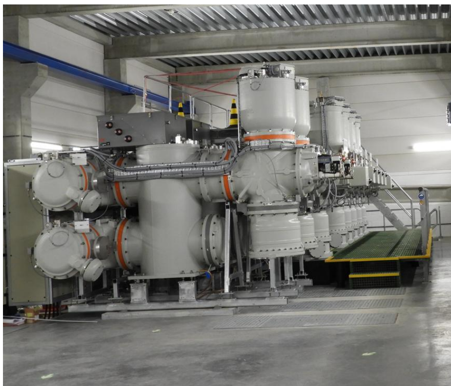
Figuur 2.5: uitbreiding GIS onderstation van Ieper
