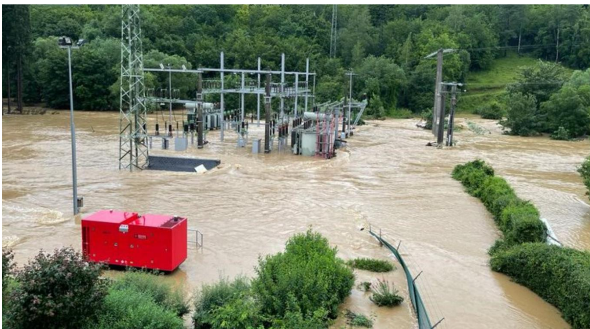
Figuur 2.8: Overstroming van een hoogspanningspost ten gevolge van de extreme regenval in juli 2021
