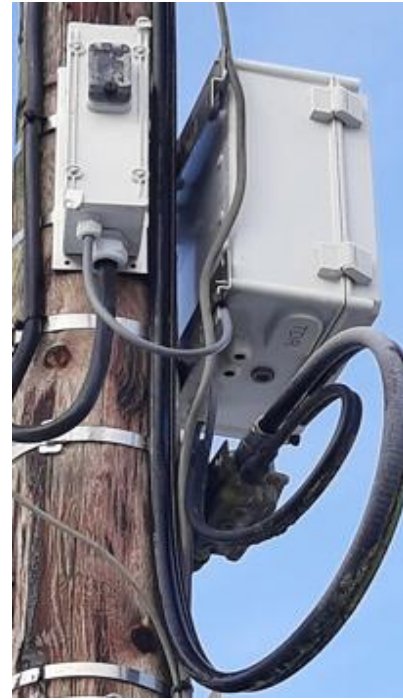
Voorbeelden van plaatsing op paal met een aftakking op een bovengronds distributienet.
